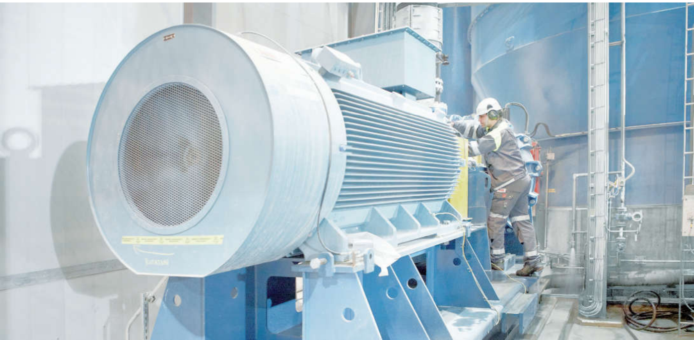
采用分项计量可显示用电处的耗电状况。
